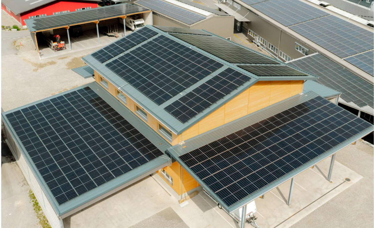
PV-Anlage auf dem Dach Gewerbegebäude (vorne) und Unterstand (hinten links)
